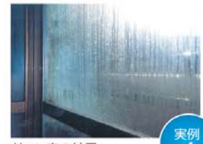
サッシ窓の結露 実例 1
